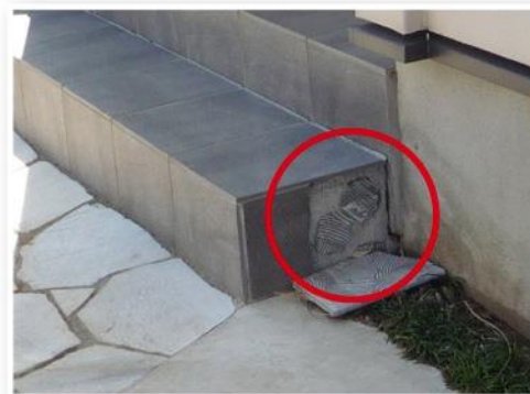
剥がれた玄関タイル
