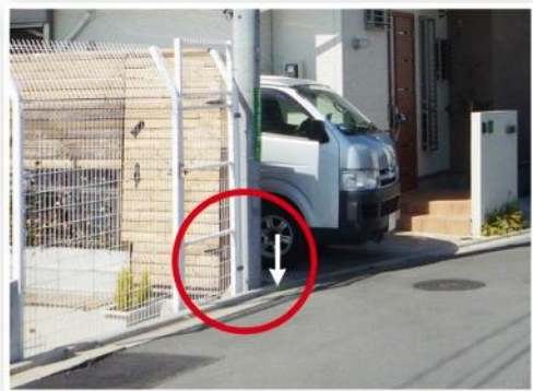
80cm沈下した電柱
