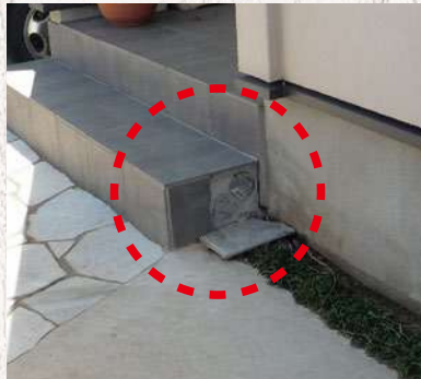
剥がれた玄関タイル
