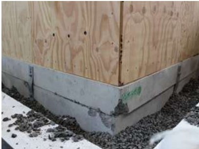
無対策実験 日立波で崩れた基礎
