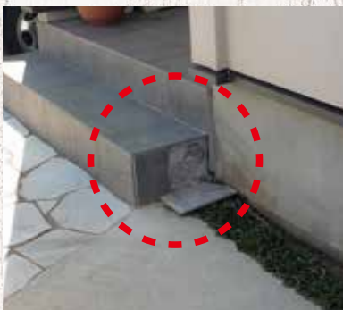
剥がれた玄関タイル
