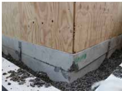
無対策実験 日立波で崩れた基礎
